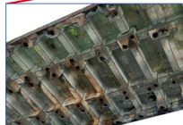
ひび割れ状況
